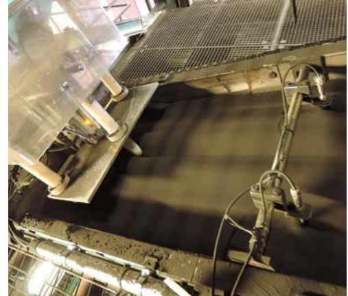
Die tripolare Mess-Elektrode TFS141 misst den Feuchtegehalt des Kreislaufsands auf dem Fließband.
