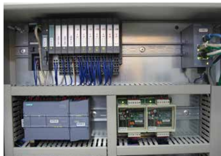
Feuchtemessung auf SPS-Basis; bis zu vier Messstellen ausbaufähig
